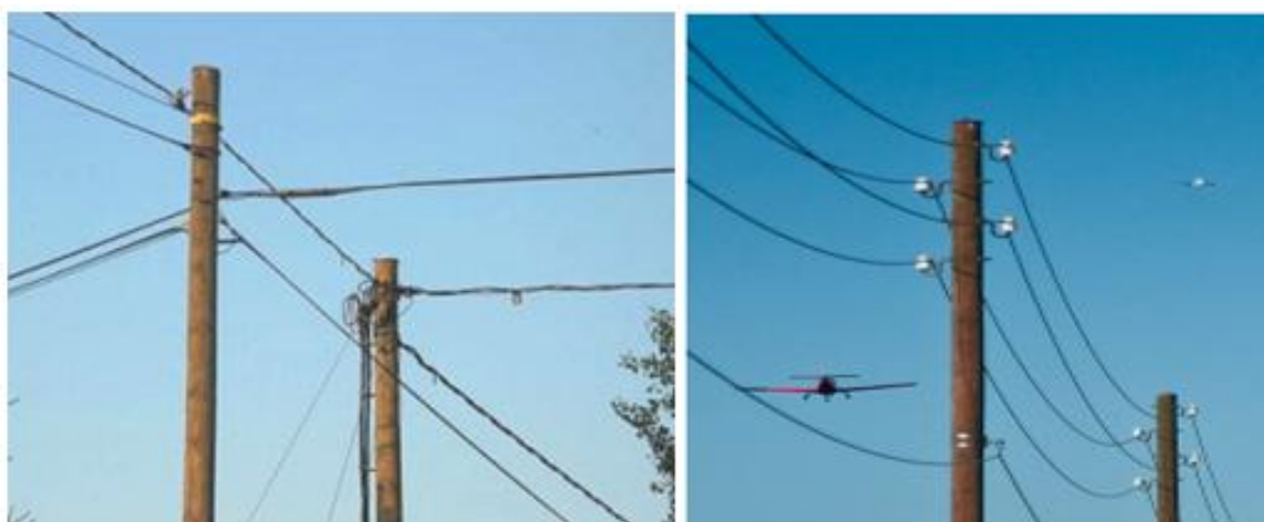
Figure 5 : Illustration de câbles et poteaux basse tension (BT)
